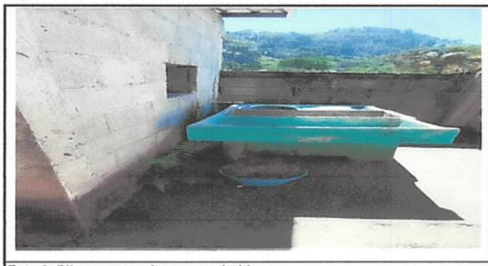
Foto 6: Pila que necesita ser sustituida
