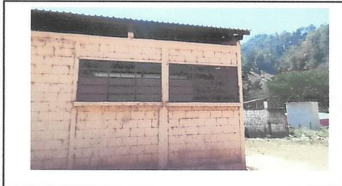
Foto 1: Ventanas en mal estado
